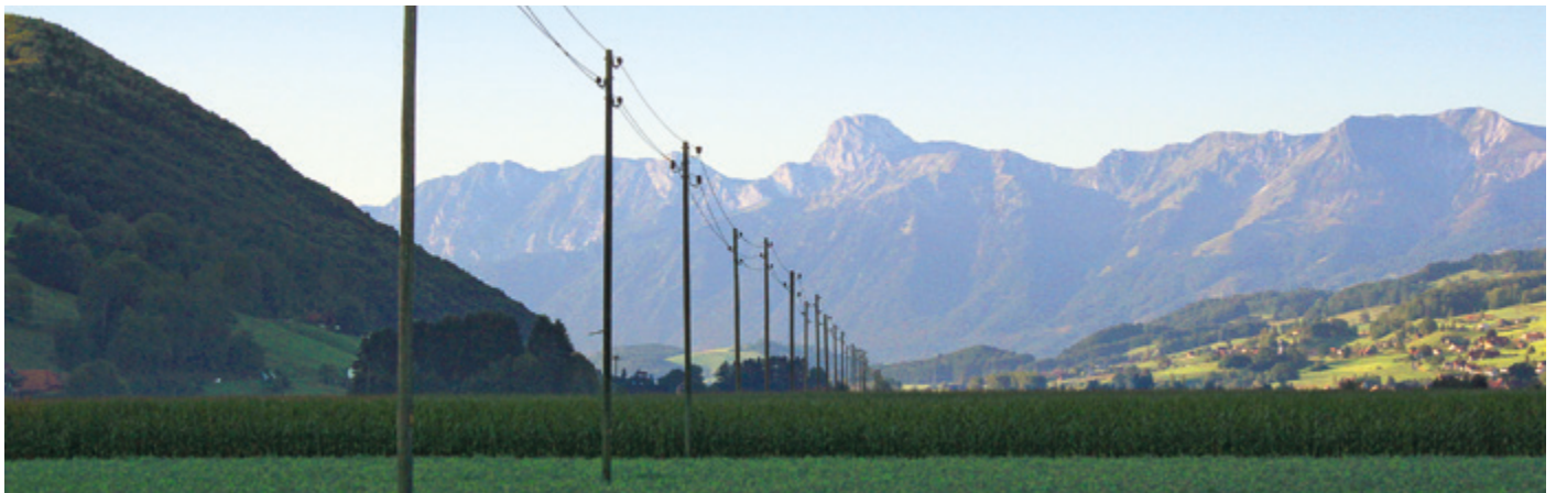
Dieser Anblick gehört schon bald der Vergangenheit an: Die Freileitung zwischen Belp und Toffen wird unter die Erde verlegt.
