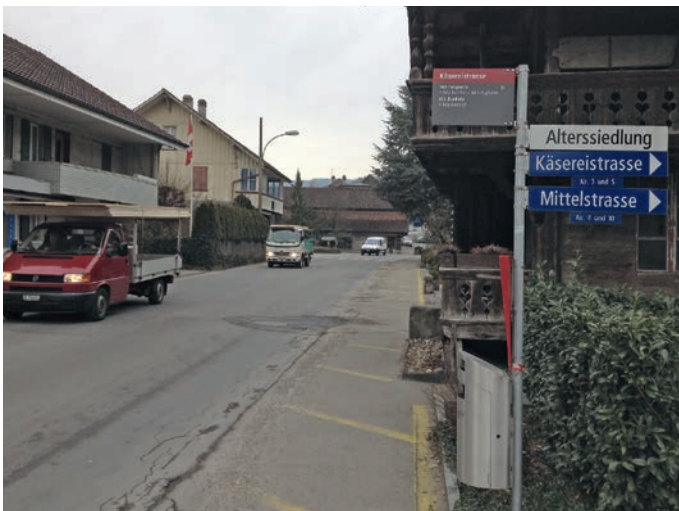
Noch hat es Risse, Löcher und Flickstellen auf der Käsestrasse. Im Sommer wird sie saniert.
