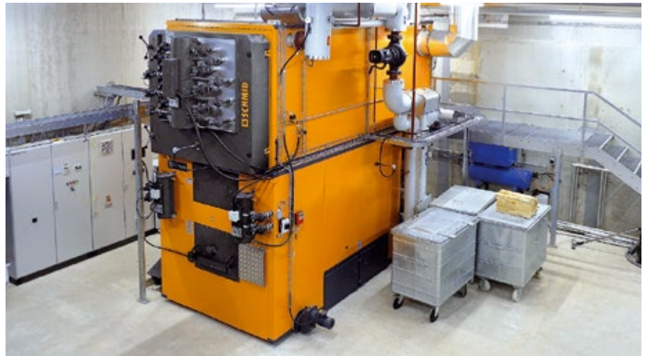
Ein Meilenstein im Geschäftsjahr 2017: Mit der Nahwärmezentrale Steinbach konnte die Energie Belp AG ihr Angebot im Bereich der Wärmeversorgung massgeblich ausweiten.
