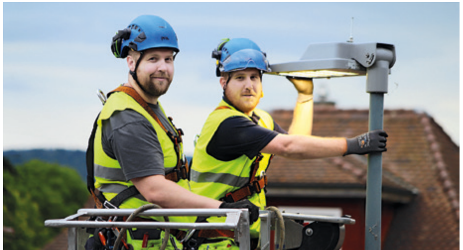
Seit Jahren wird die Belper Strassenbeleuchtung kontinuierlich auf LED-Technologie umgerüstet.
