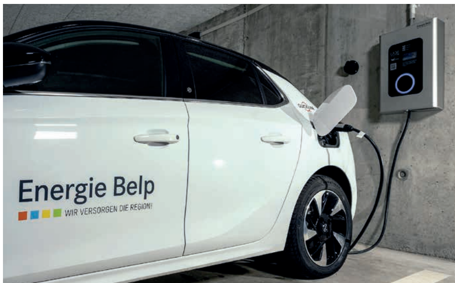
Eine intelligente Ladeinfrastruktur ist nicht nur für die Fahrerinnen und Fahrer von Elektroautos praktisch. Sie hilft auch die Last im Stromnetz zu kontrollieren und Verbrauchsspitzen abzufedern.
