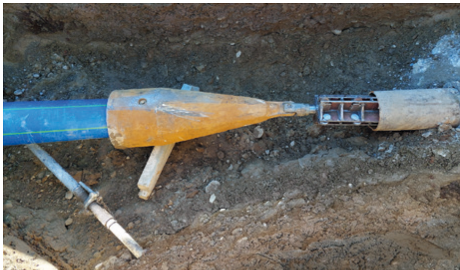
Das neue Rohr wird mit dem Berstkörper voran in die defekte Leitung gezogen.
